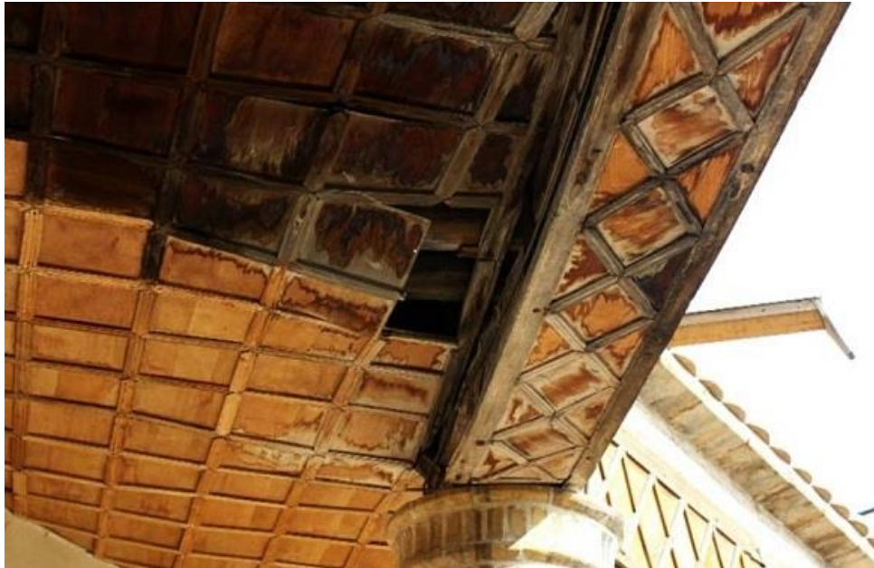
شکل ۲) رطوبت ایجاد شده در سقف راهرو و مغازه‌های میدان جلفای اصفهان در سال ۱۳۹۶
