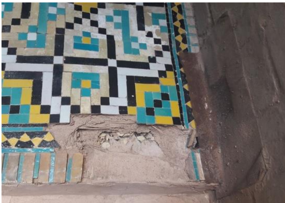
شکل ۳) رطوبت ایجاد شده در دیوار شبستان مسجد تاریخی آقانور در محله تاریخی در دشت اصفهان در سال ۱۳۹۵
